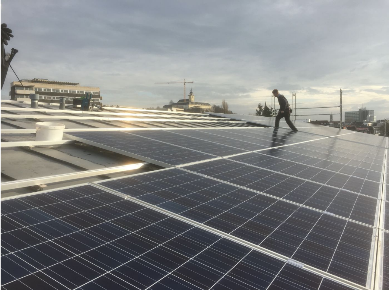
Montage einer Photovoltaikanlage (263 kWp, zehn verschiedene Dachausrichtungen, Neubau der Niederspannungshauptverteilung, 80 % Eigenverbrauch); Foto: Thomas Schmitz
